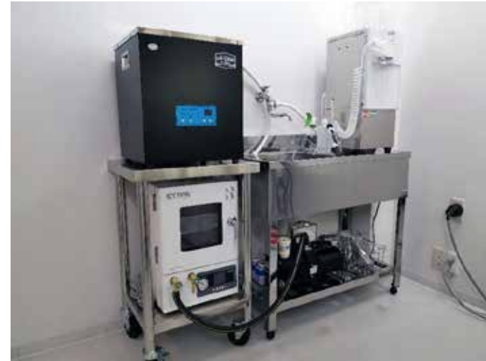
クリーンルーム内に超純水洗浄台
